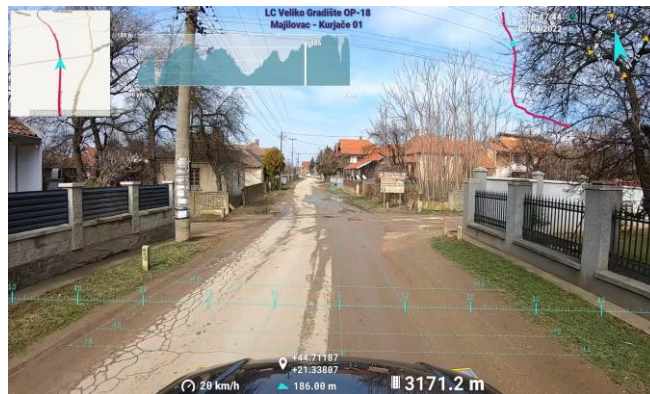
Слика 3. Оштећења асфалтног коловоза и мрежасте пукотине, деоница ОП-18 Извор: (SAFEGE DOO, 2023)
