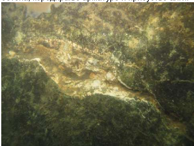
Слика 8. Оштећење стуба у води од ерозије, леда и растиња.
