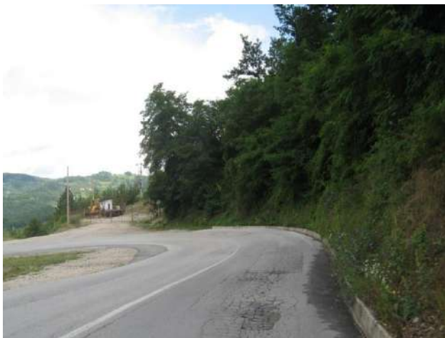
Slika 2. Oštećenja i deformacije kolovoza na deonici puta Volujac-Zaglavak
