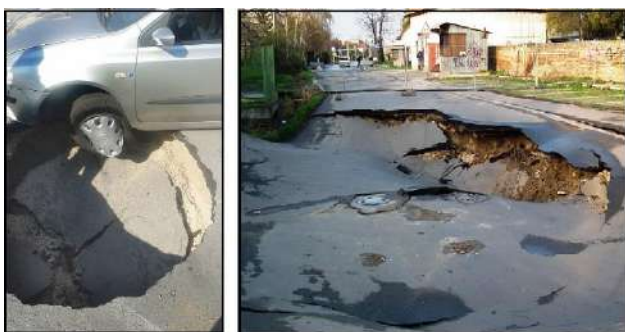
Slika 8. Primer oštećenja na kolovozu [11] [12]
