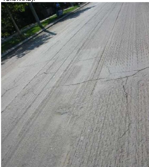
Слика 4. Стање површине након стругања застора
