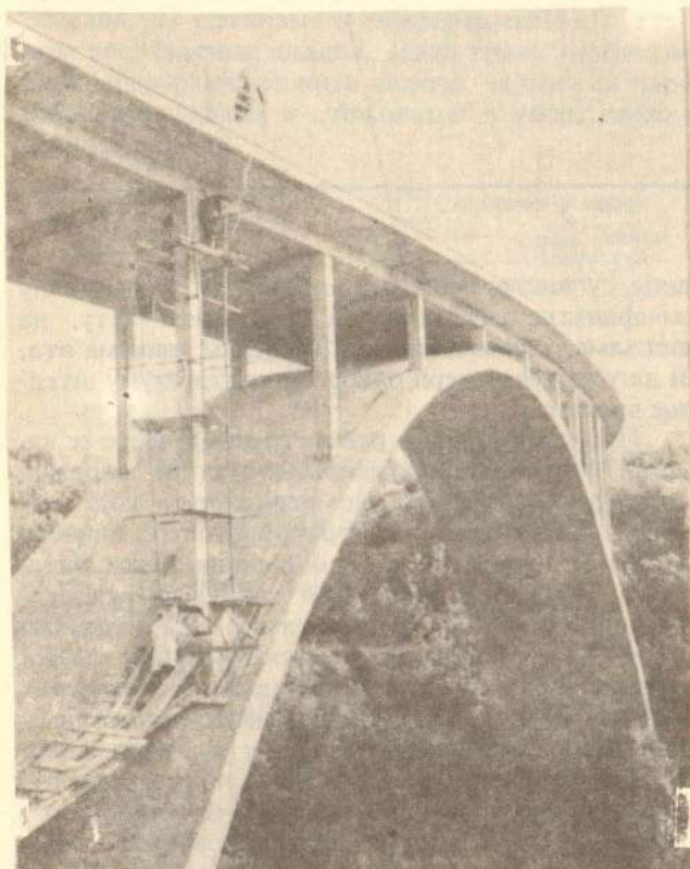
Сл. 1 — Санирање оштећења моста изазваног недисциплином возача који је превезао ванредни терет велике тежине
