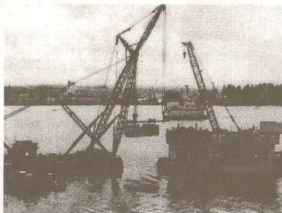
Монтажа челичне конструкције моста преко Саве на обилазници ауто пута око Београда, главни отвор распона L = 198,0 м.
